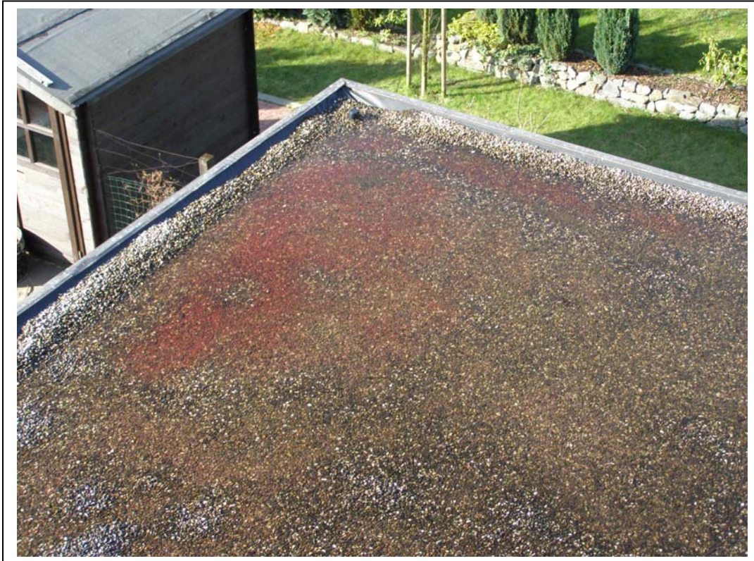
Bild 5: Rotalgenbefall auf einem bekiessten Garagendach
