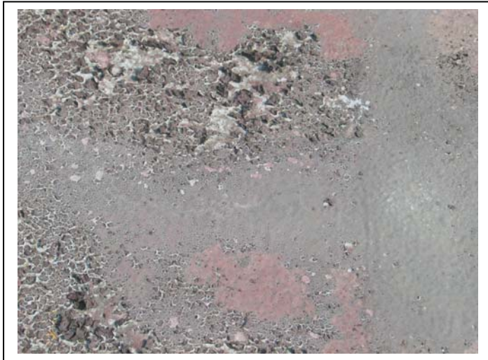
Bild 10: Aufbruch der Oberfläche nach einem Rotalgenbefall
