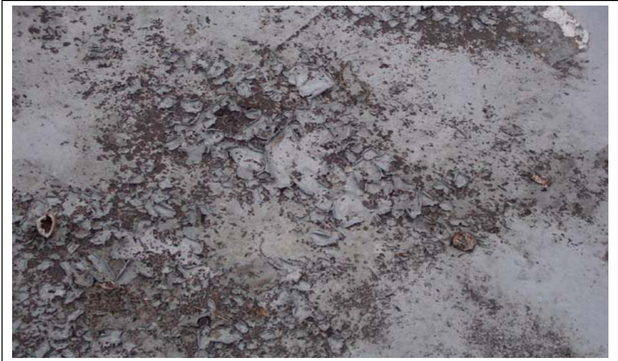
Bild 3: Fortgeschrittener Algenangriff in einer trockenen „Pfütze“. Die Oberfläche löst sich ab und beginnt sich langsam aufzurollen. Die Oberfläche sieht dann aus wie welkes Laub.
