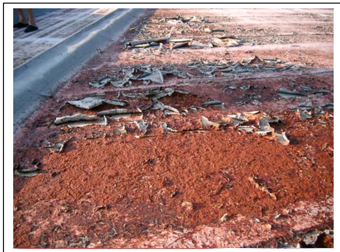
Bild 11: Endstadium: Die betroffene Oberfläche hat vollständig aufgelöst.
