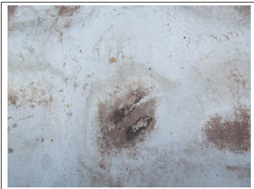
Bild 7: Eine einzelne trockenliegende Pfütze mit erstem Rotalgenbefall
