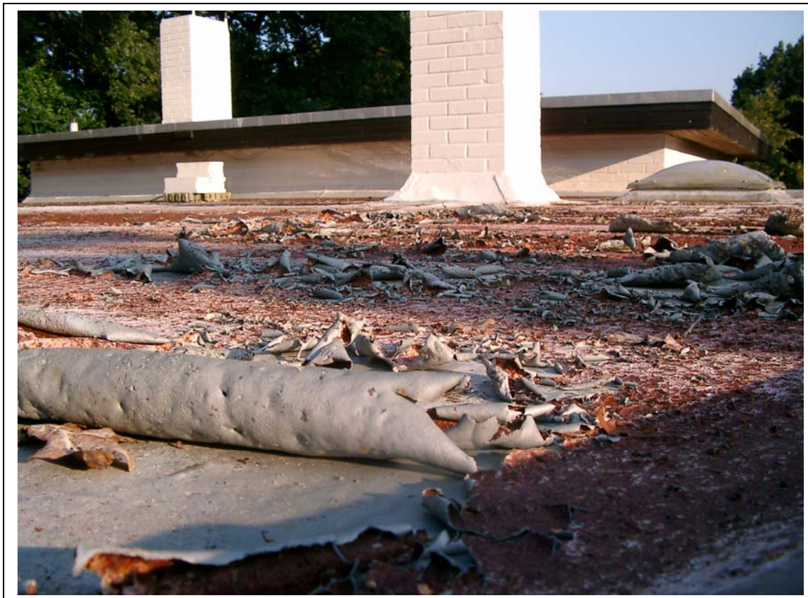
Bild 1: Völlig zerstörte Oberfläche auf einem Flachdach, der Untergrund löst sich und rollt sich stellenweise großflächig auf.
